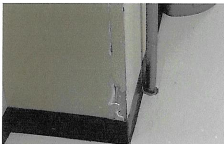
Figure 6.3 Exemple de coin fissuré
